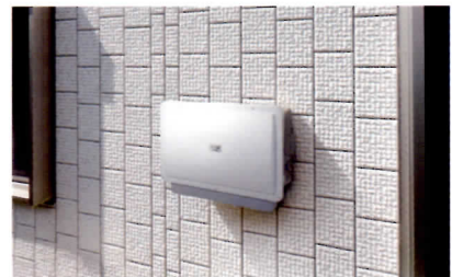
パワーコンディショナ：屋外壁掛け設置
