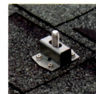
アスファルトシングル屋根
